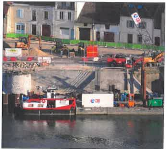
Encore un chantier emblématique qui se découvre réellement vu du ciel : la rénovation des perrés sur l'île Saint-Laurent. Une partie est déjà terminée. Photo Grégory JACOB
