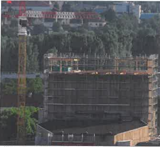
Voici un des chantiers emblématiques qui est en cours à Chalon en ce moment : la rénovation de l'Espace des arts. On voit clairement l'ossature de la future surélévation. Photo Grégory JACOB
